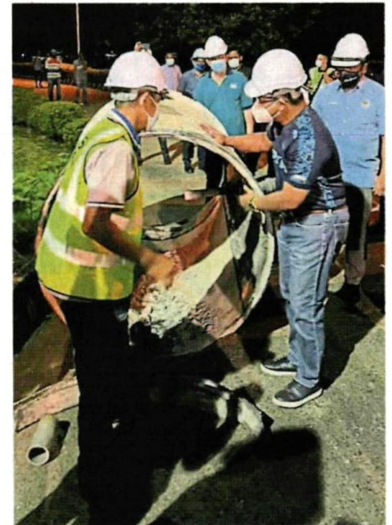
用了 27 年的阀管已磨损，必须更换。
